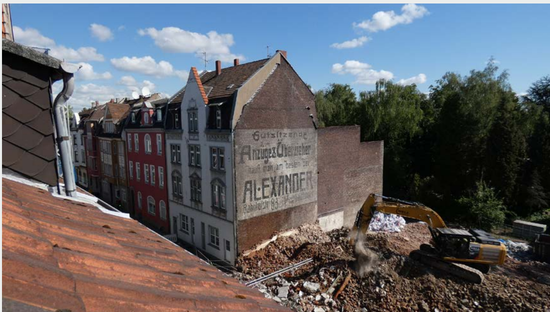
Die Mauer am Haus der Bochumer Straße 165 Bildrechte: Stadt Gelsenkirchen
