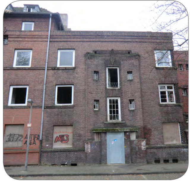
Vor der Sanierung: in desolatem Zustand
