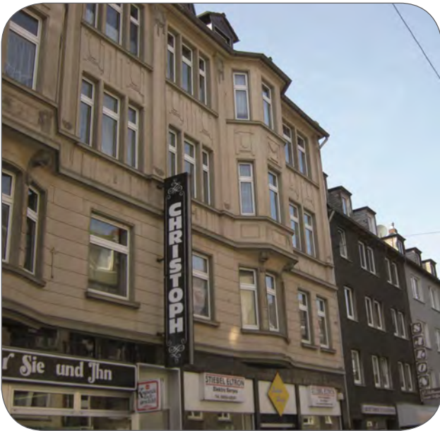
Die historische, aber in die Jahre gekommene Fassade...
