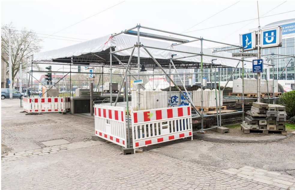
Abbildung 3: Dieser Abgang ist seit dem 28. Juni gesperrt (Quelle: Caroline Seidel)
